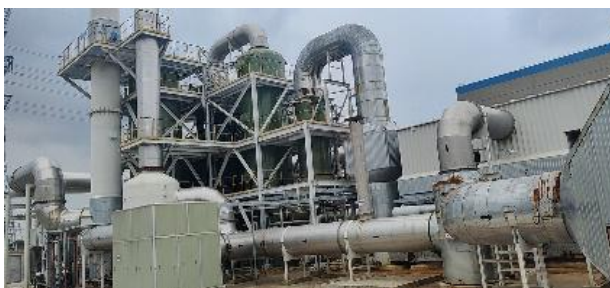
7#RTO 焚烧系统
