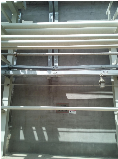
一期水解沉淀池
