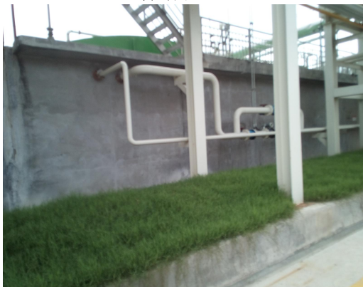
二期反硝化池
