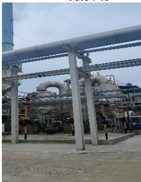
1#RTO 焚烧系统
