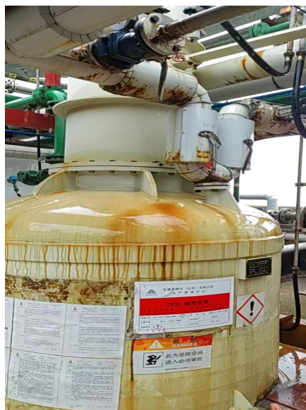
一级碱喷淋-钾盐废水预处理
