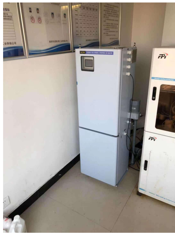
废水总排口-总磷在线
