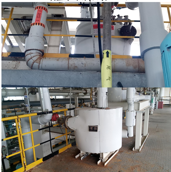
一级盐水冷冻(回收甲苯)-粉唑醇合成、环氧化物合成
