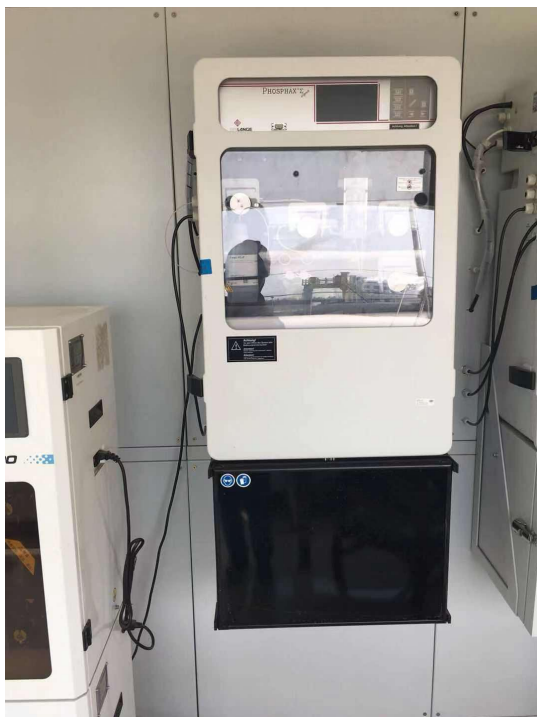
废水总排口-氨氮在线
