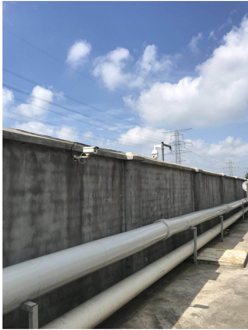
危废库外视频监控
