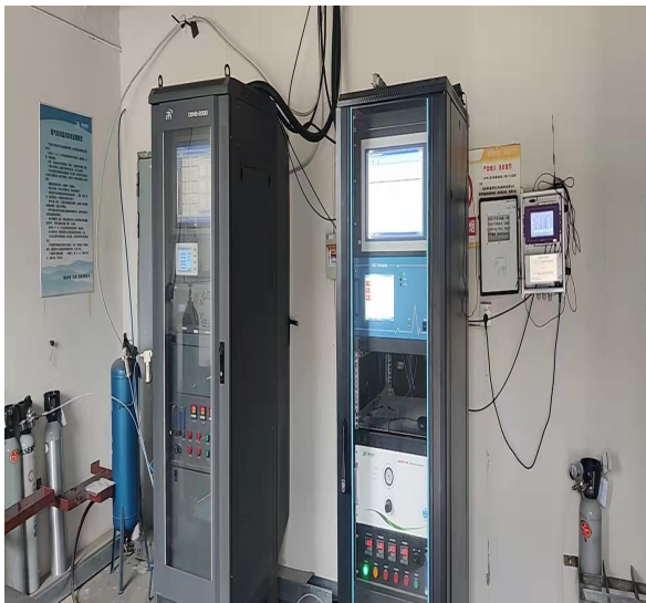
5#RTO 焚烧炉系统在线 CEMS/非甲烷总烃
