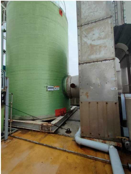
E40 车间室内换风-一级水喷淋
