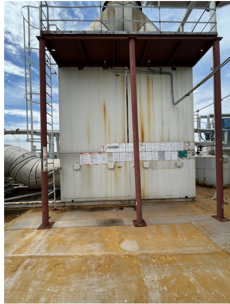
E40 车间室内换风-一级活性炭吸附
