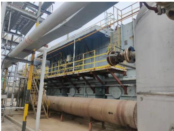
5#RTO 焚烧系统
