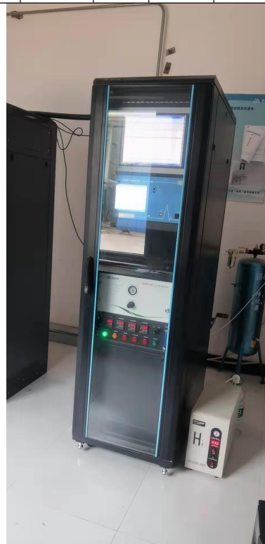
1#RTO 焚烧炉系统在线非甲烷总烃
