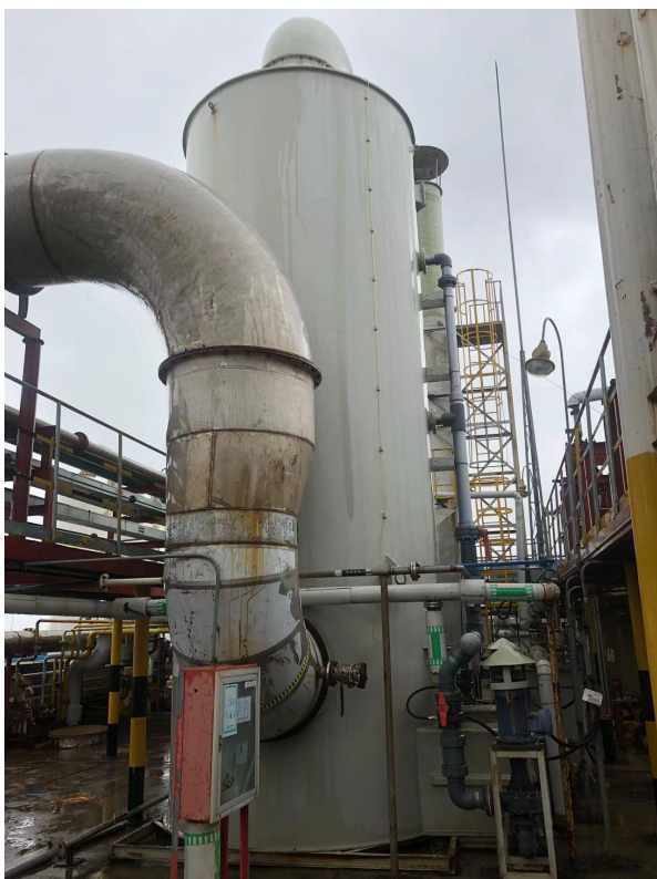
B40 车间（顶楼）室内换风-一级水喷淋
