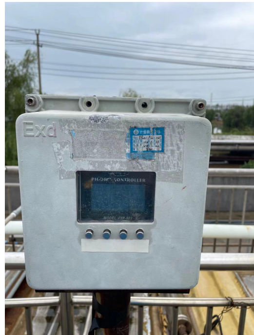
废水总排口-pH 在线
