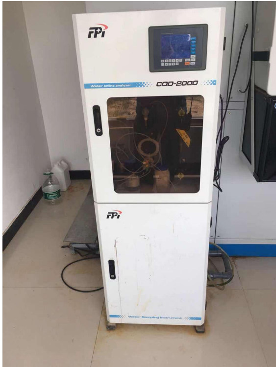
废水总排口-COD 在线
