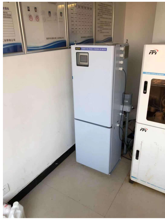
废水总排口-总磷在线
