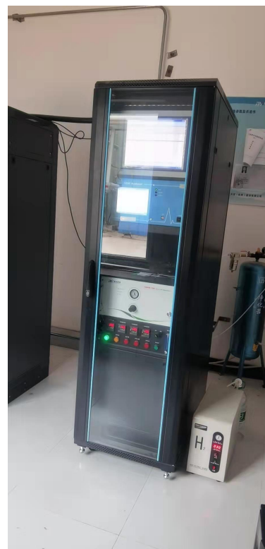
1#RTO 焚烧炉系统在线非甲烷总烃
