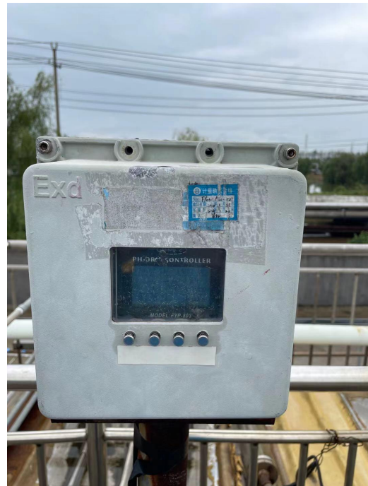
废水总排口-pH 在线
