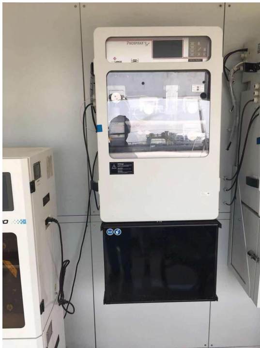
废水总排口-氨氮在线
