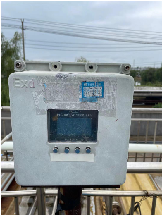
废水总排口-pH 在线
