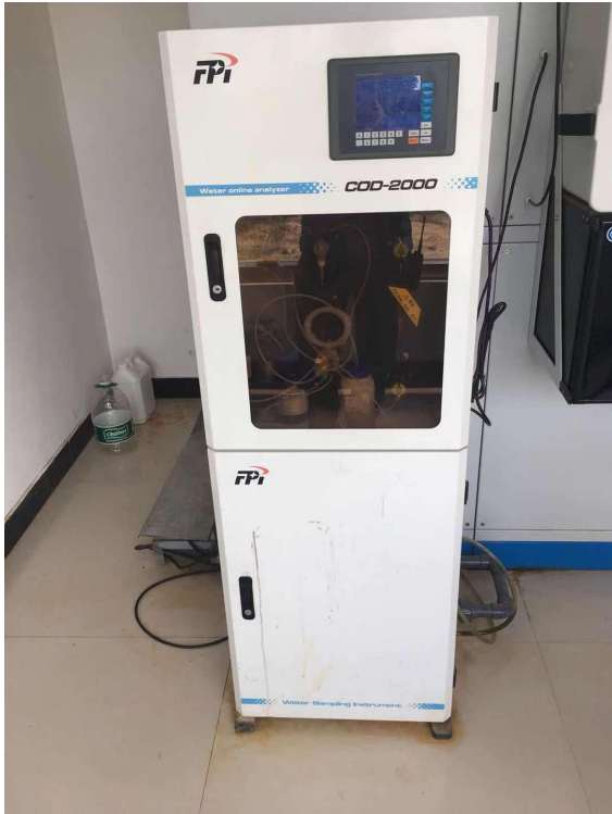
废水总排口-COD 在线
